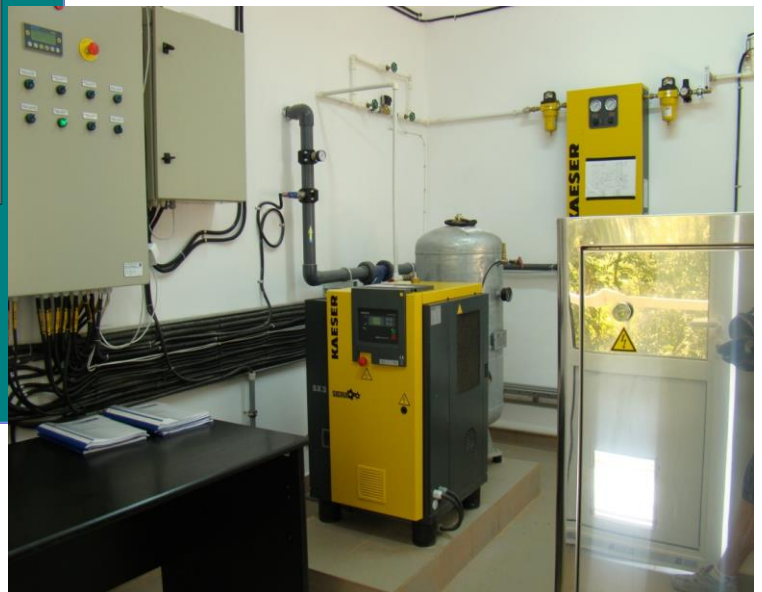
Camera generatorului de ozon și a sistemului de comandă al stației
